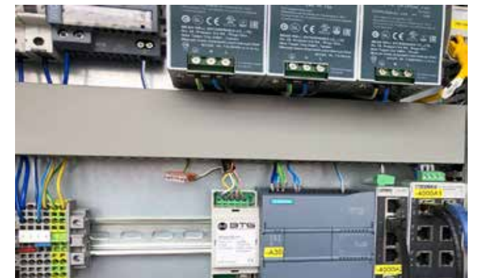
Schaltschrank mit smart plastics Modulen
